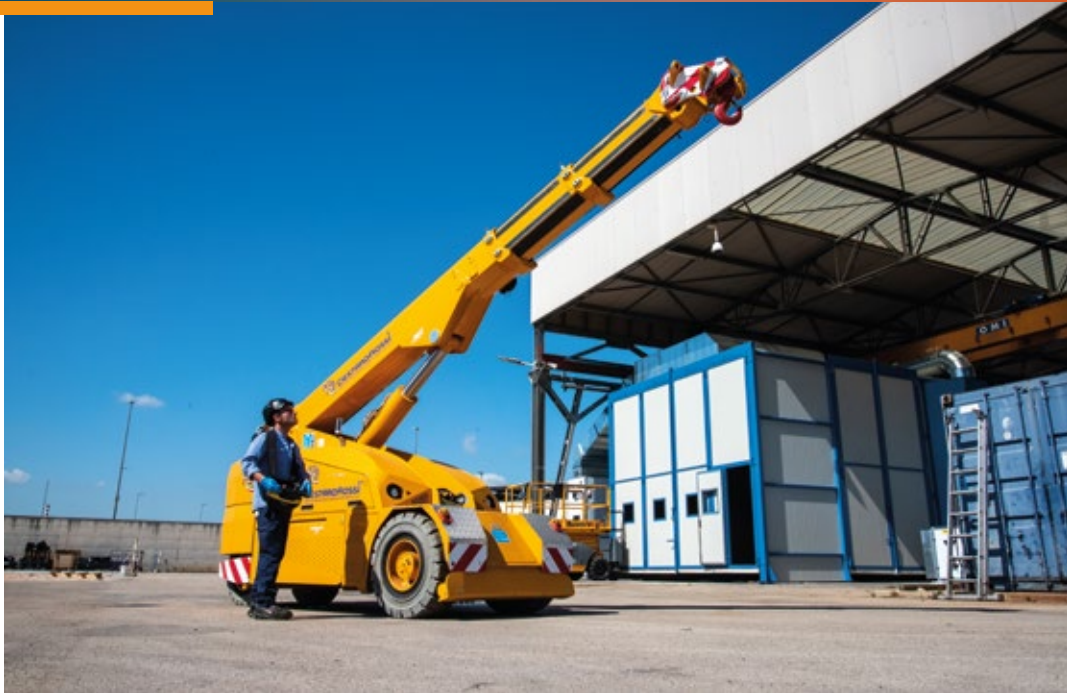
GRU ELETTRICA A COMANDO REMOTO
